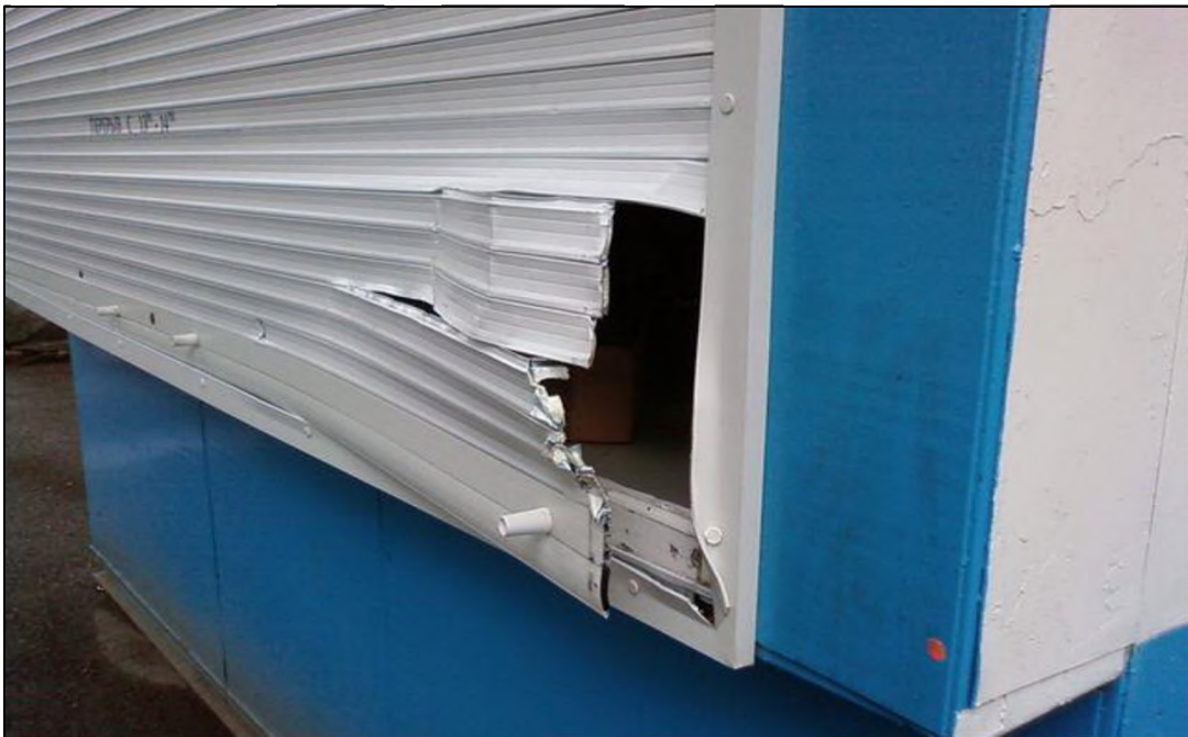
Рисунок 25 – Разрушения фрагмента полотна рольставней
